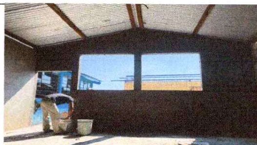
FOTO 6: REPELLO EN MURO EN MODULO DE AULA
